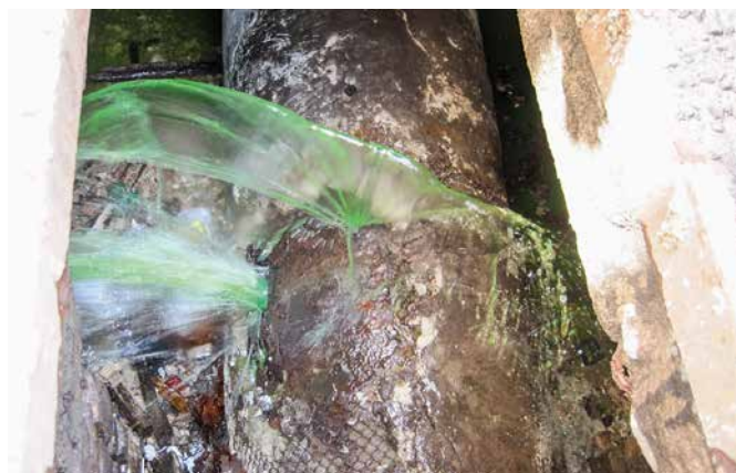
Cauruļu bojājumi un ūdens noplūdes (ilustratīvs materiāls no bojājumiem dažādās Rīgas vietās)
