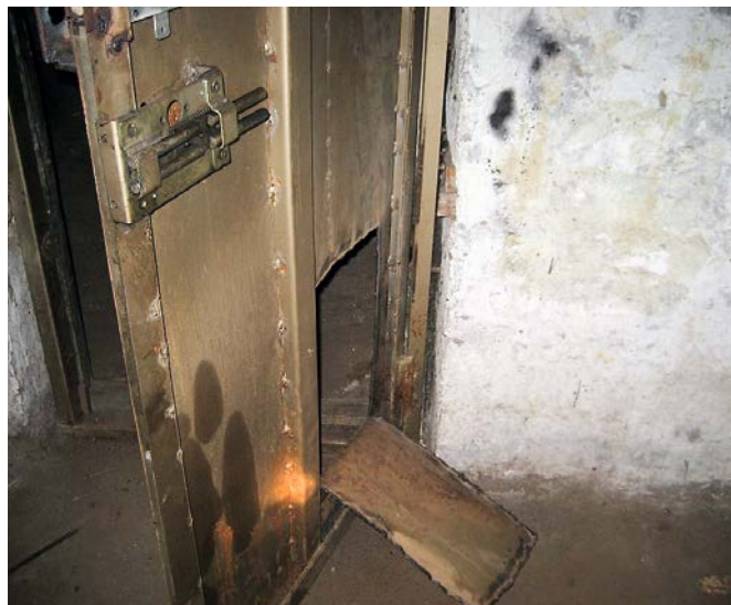
Lai iekļūtu siltummezglos, zagļi ar griezējdegļu palīdzību izgriež caurumus metāla durvīs
