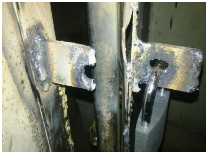
Zagļi sabojājuši durvju atslēgas, lai iekļūtu siltummezglā
