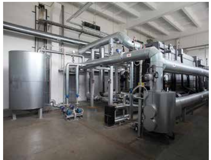
Siltumcentrāles "Imanta" koģenerācijas energobloka siltumsūkņi, kas ļauj, nepatērējot kurināmo, iegūt papildus 2 MW siltumenerģijas, utilizējot zema potenciāla dzesēšanas ūdens siltumenerģiju.
