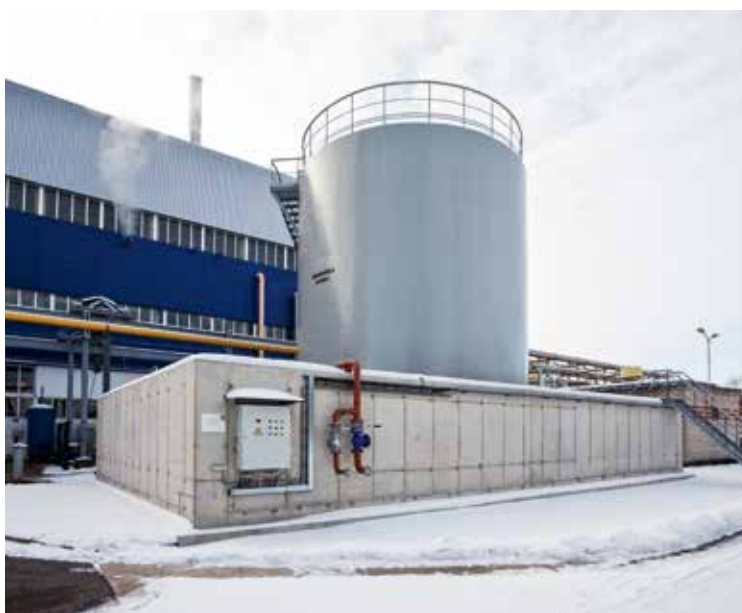
Siltumcentrālēs "Imanta" dīzeldegvielas rezervuārs ar tilpumu 400m 3 . Paredzēts ierīkot papildus vēl divas līdzīgas tvertnes, lai paaugstinātu siltumapgādes drošību iespējamu dabasgāzes padeves pārtraukumu gadījumā.
