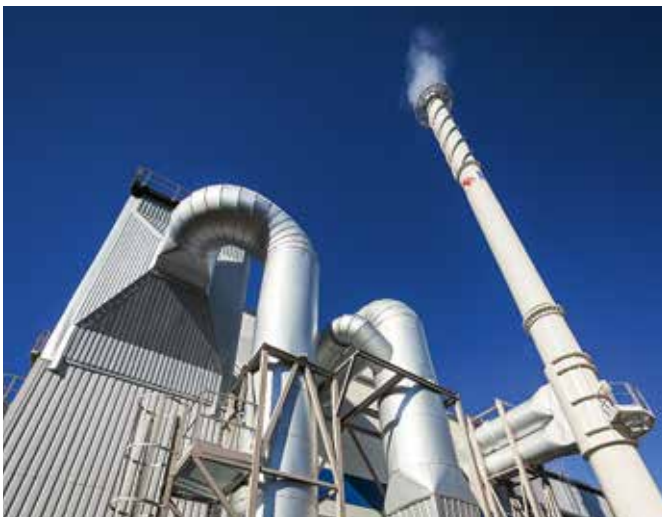
Siltumcentrāles "Zasulauks" biokurināmā katlu mājas fasāde (skats uz elektrofiltru, gāzējām un dūmeni). Biokurināmā katls darbojas pilnīgi automātiski bez dežūrpersonāla uzraudzības ar attālinātu vadību no siltumcentrāles "Imanta" pults.
