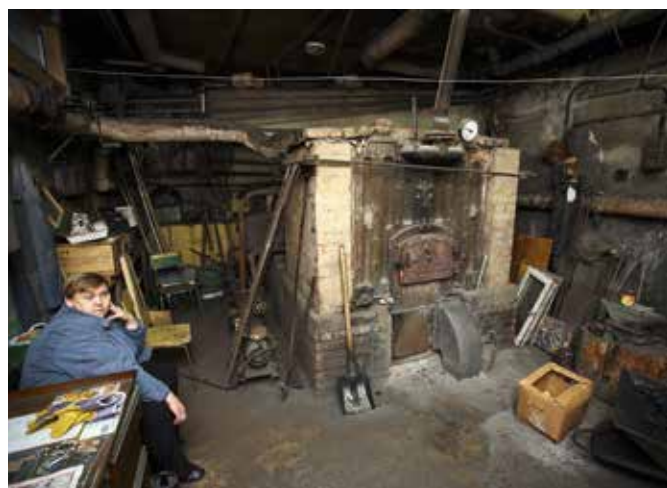
Ogļu katlu māja ar kurinātāju. Tipiska aina – melni griesti, galvenais instruments lāpsta un ārpus kadra ogļu kaudze.
