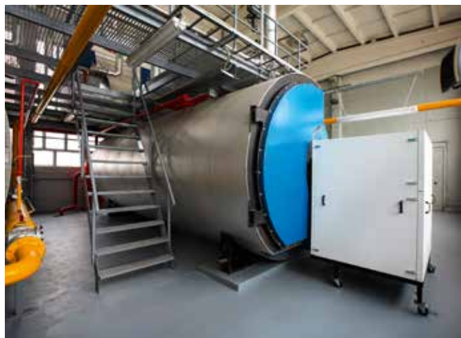
Vidējas mazas jaudas automatizēta bezpersonāla dabasgāzes katlu māja Kuģu ielā 26a.
