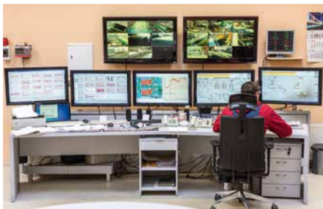
Mūsdienų dežūrinženiera darba vieta siltumcentrālē "Vecmilgrāvis". No šīs pults tiek vadīti siltumcentrāles biokurināmā un dabasgāzes katli. Siltumcentrāles personāls, izmantojot datortehniku, uzrauga vēl 35 vidējas un mazas jaudas gabasgāzes katlu māju darbību, no kurām vienā ir arī koģenerācijas energobloks.
