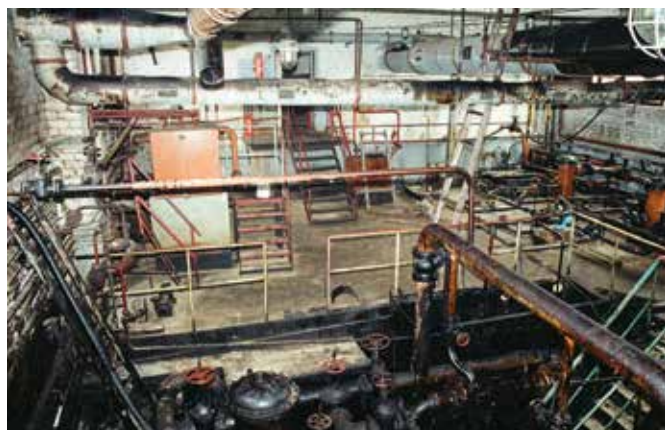
Siltumcentrāles "Daugavgrīva" mazuta saimniecības sūkņu stacija. Siltumcentrāli Rīgas pilsētai nodeva Padomju armija ļoti sliktā tehniskā stāvoklī un tā bija "vienīgā AS "RĪGAS SILTUMS" katlu māja ar mazutu kā vienīgo kurināmo. Šobrīd siltumcentrālē ir gāzificēta un tajā darbojas arī biokurināmā katls.
