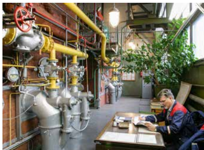
Vidējas jaudas dabasgāzes katlu māja Kuģu ielā 26a pirms rekonstrukcijas. Pilnīgs pretstats ogļu katlu mājām – viss ir tīrs un kārtīgs.
