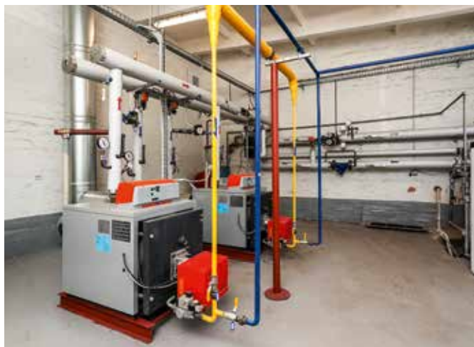
Tipiska mazas jaudas automatizēta bezpersonāla dabasgāzes katlu māja, kas izbūvēta likvidējot pagraba ogļu katlu māju.
