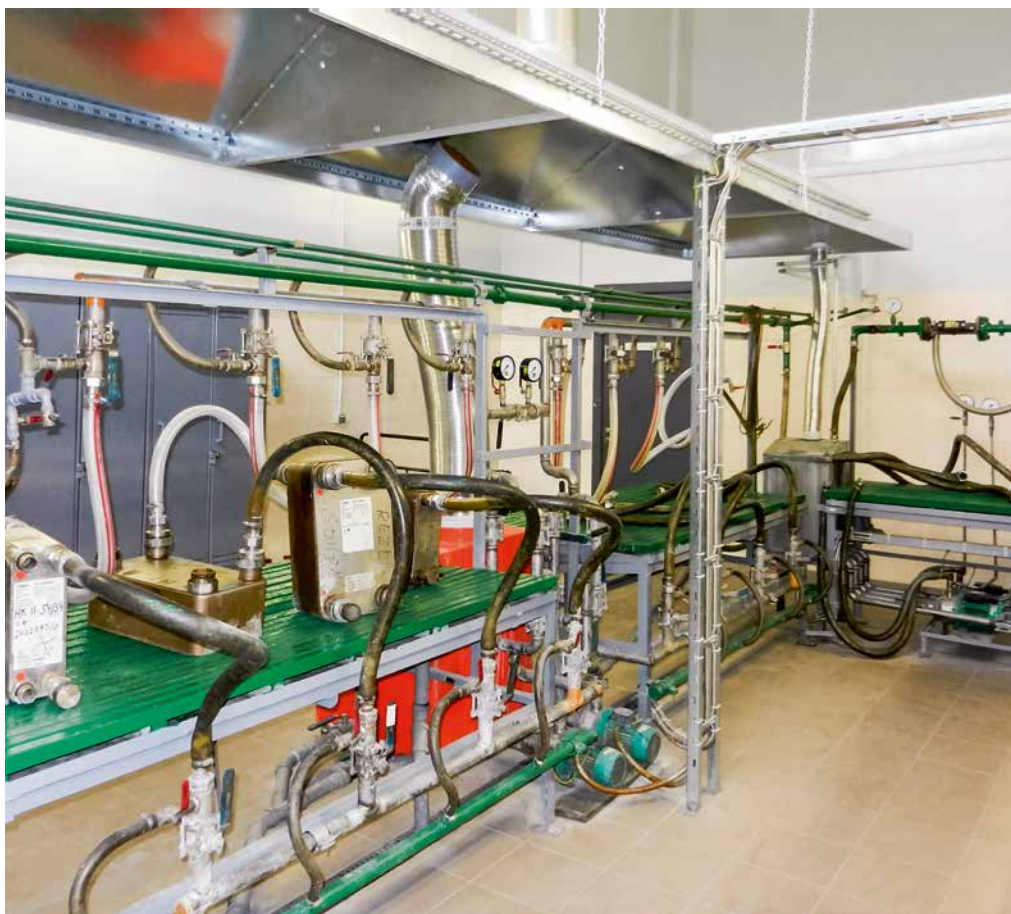
Ēkās uzstādīto siltummaiņu skalošana tiek veikta 5 skalošanas stendos, kuri ir aprīkoti ar modernām iekārtām un atbilst ugunsdrošības, elektrodrošības, vides un darba higiēnas prasībām.
