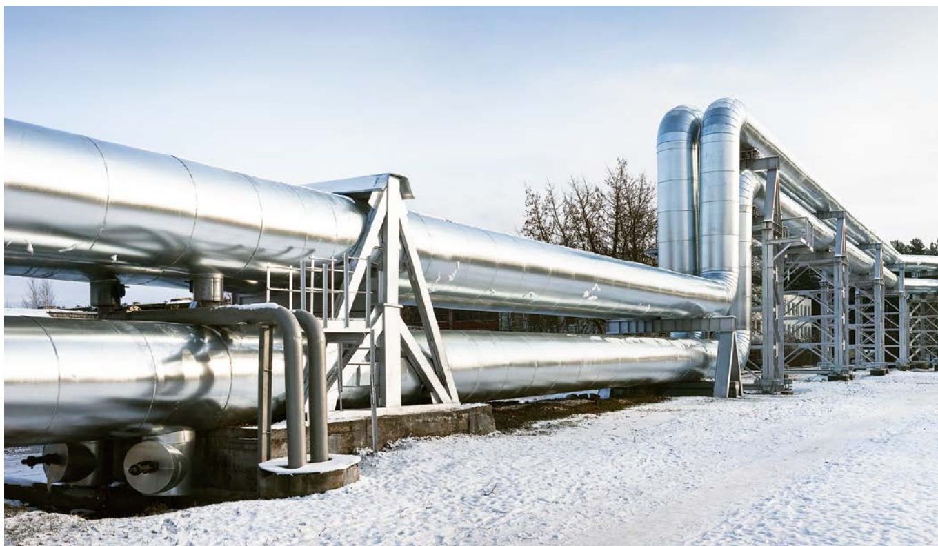
Siltumtīklu maģistrāļu M-10, M-20 virszemes posms
