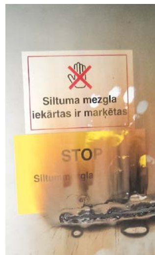
Siltummezgls ar norādi par marķētām iekārtām
